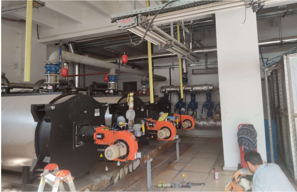
Merkez Kampüs Isı Merkezi İşİ
